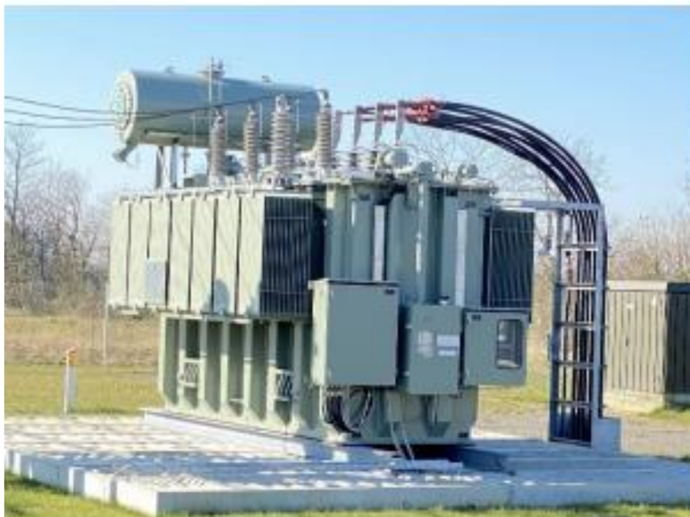
Figur 3-15. Eksempel på forsyningstransformer. Kilde: Ecosolar.
