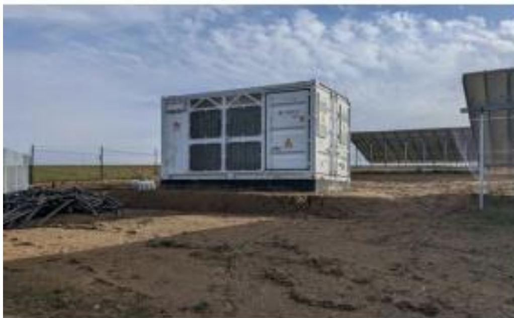
Figur 3-13. Foto eksempel på parktransformer. Kilde: Ecosolar.
